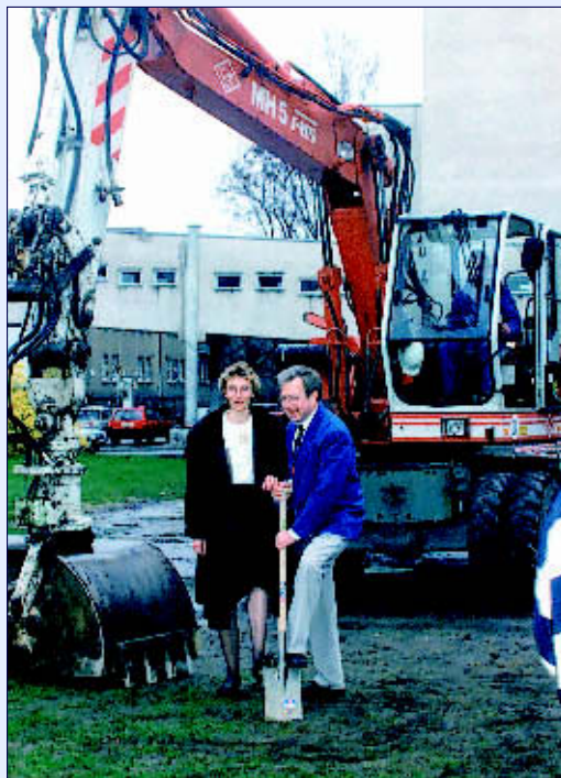
Erster gemeinsamer Spatenstich am 10. April 1994 von Klinikdirektor Prof. Wilfried Döhring und Heike Steinberg vom Staatshochbauamt für das neue Schnittbildzentrum
