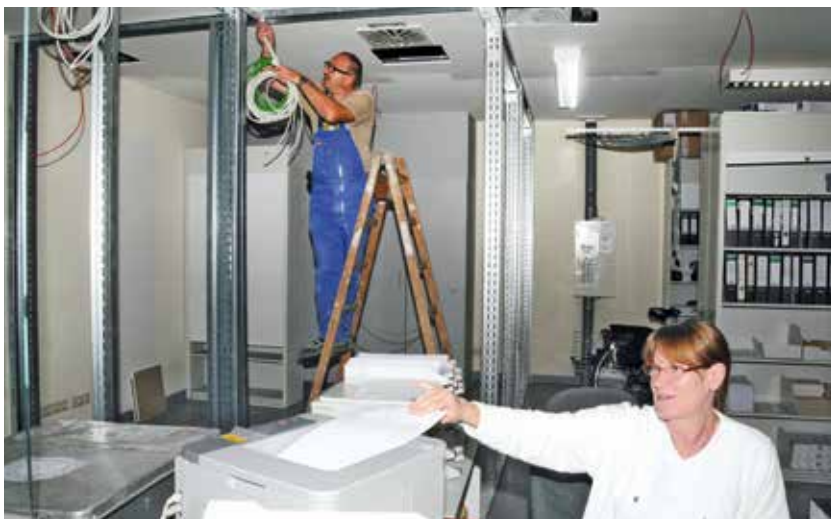
Der Umbau erfolgte während des laufenden Klinikbetriebs. Foto darunter: Getrennte Eingänge für Rettungsdienste und Patienten.
